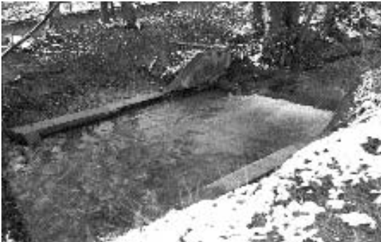
Auch im naturnahen ‚Abschnitt ‚Vauban‘ sind noch viele Betonreste zu finden.
